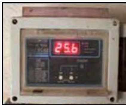
Figura 1.- Control de temperatura.
