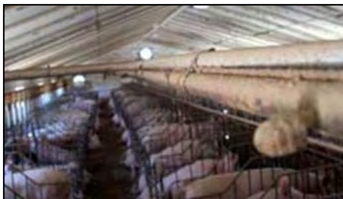
Figura 6.- Sistema de refrigeración por nebulización.
