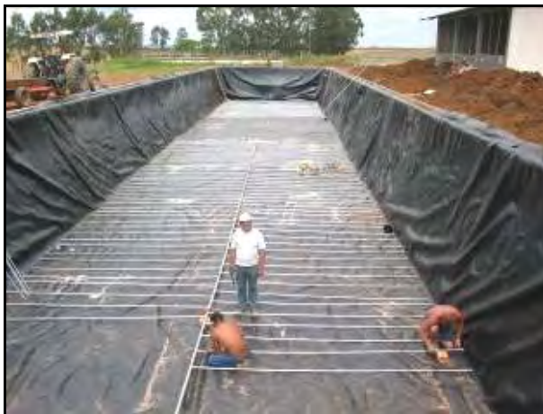
Figura 6.- Instalación de las mangueras de recirculación de biogás en el fondo del digester principal. Esta recirculación de gas desde el fondo del digester favorece el ciclo de producción de metanol y evita la deposición de sólidos en el fondo del digester. Obsérvese la capa aislante contra el piso de tierra. Este recubrimiento es una lona especial que tiene una vida útil de más de 20 años.
