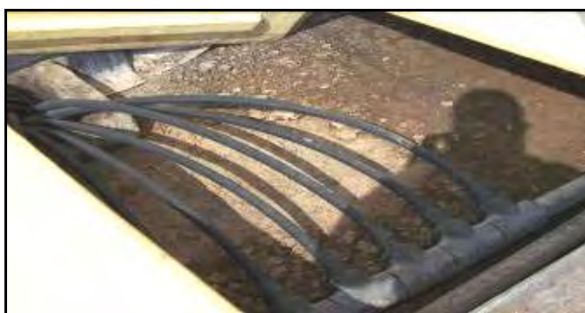
Figura 8.- Vista de la entrada de agua caliente proveniente de la refrigeración del motor co – generador de energía eléctrica que se encuentra en la sala de maquinarias al costado del digester principal. La entrada de la cañería plástica es por la punta del digester.
