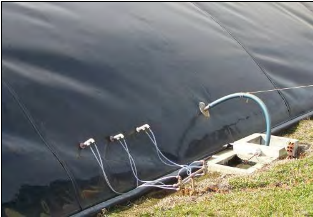
Figura 15.- La foto muestra la entrada de 3 de las 6 mangueras que inyectan oxígeno al biodigestor primario. La manguera de mayor diámetro es la que conduce el biogás al compresor para que lo comprima en un depósito externo. Desde este depósito se manda el biogás a la red que lo distribuye en el establecimiento.
