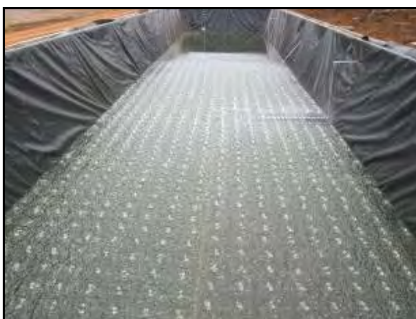
Figura 7.- Sistema de recirculación de biogás en funcionamiento, previo llenado del digester con una capa de agua. La foto muestra la prueba del sistema antes de ser llenado y tapado, el burbujeo del gas o presión es lo que muestra la foto.
