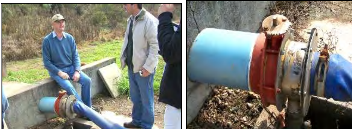
Figura 20.- Rampa de carga y detalle de la llave que permite la salida del biofertilizante hacia la manguera de carga
