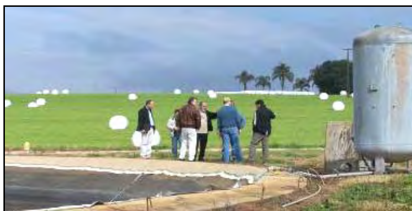
Figura 18.- Vista parcial del depósito de biofertilizante. A la derecha de la foto el depósito de biogás que genera este y que utiliza para la agitación del digester primario.
