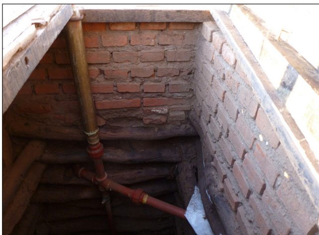
Figura 11. Cilindro instalado sobre la cañería "patas de araña" en el jagüel del molino.
