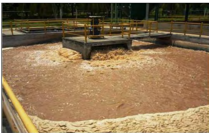
Foto 6; Reactor nº 2, Tratamiento Biológico lodos activados. Productos Lácteos Flor de Aragua
