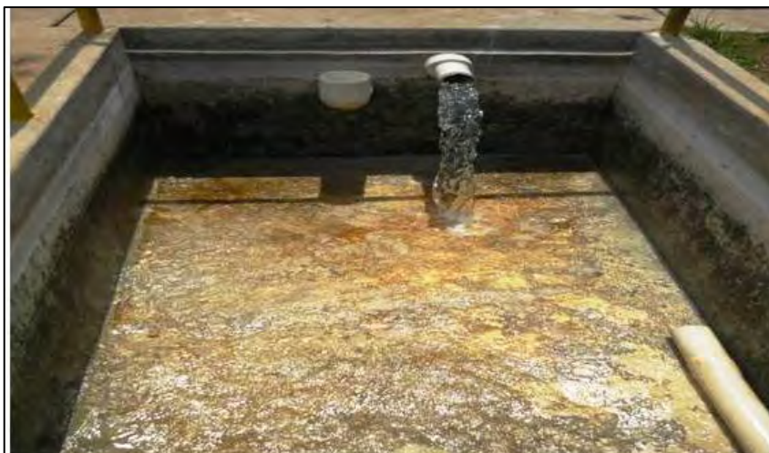
Foto 7: Descarga de Efluente Tratado Hacia Laguna de Pulimento. Productos Lácteos Flor de Aragua
